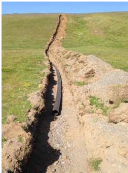
Aðrennislögn að stöðvarhúsi (júlí 2013)
