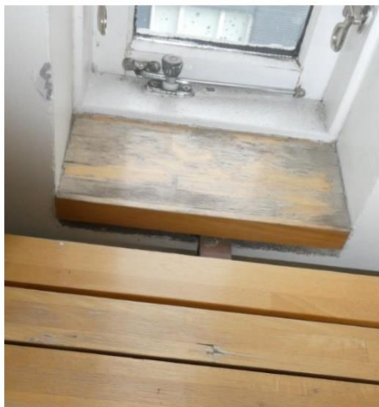
Mynd 11: Raka skemmd við opnanlegt fag [35].
